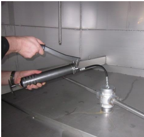
Smörjning av nedre vattenfördelaren
