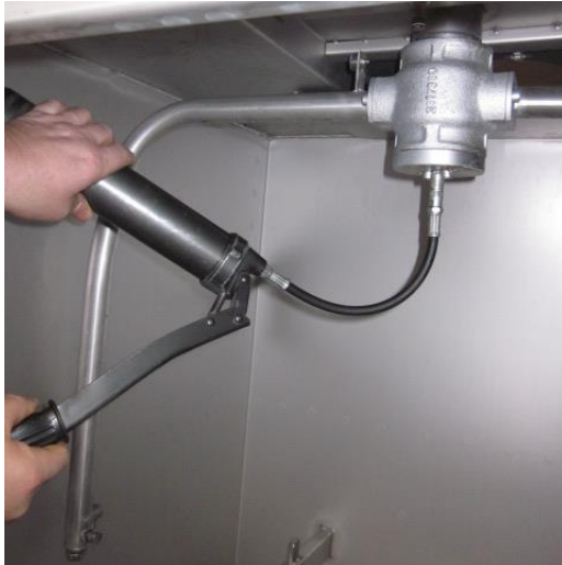
Smörjning av övre vattenfördelaren
